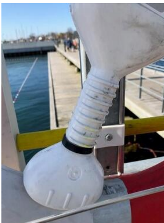
Fastgjort redningskrans til stolpen
