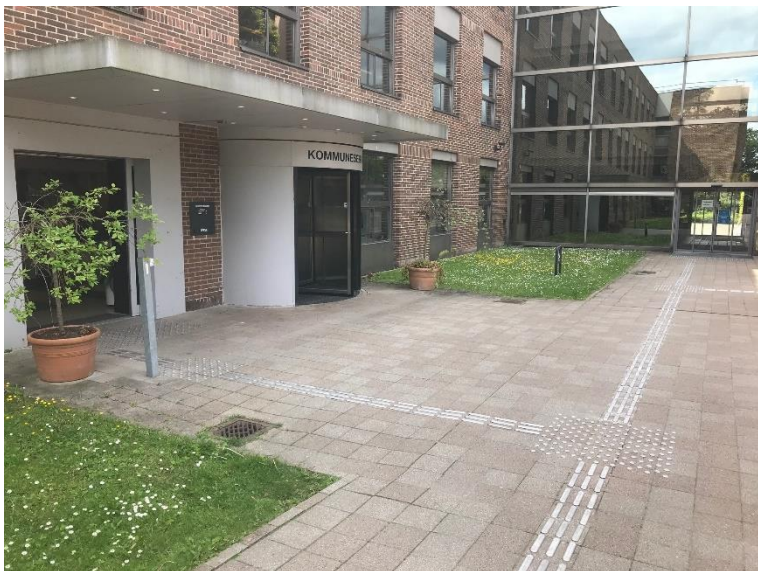
Taktile ledelinjer og opmærksomhedspunkter på belægningen til rådhusets indgange.
