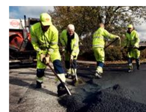
Det er vigtigt, at afspærringen ikke flyttes eller fjernes, da den er der både for at beskytte de folk, der arbejder på stedet og trafikanterne i området og for at undgå, at du og dine kæledyr får sorte poter
