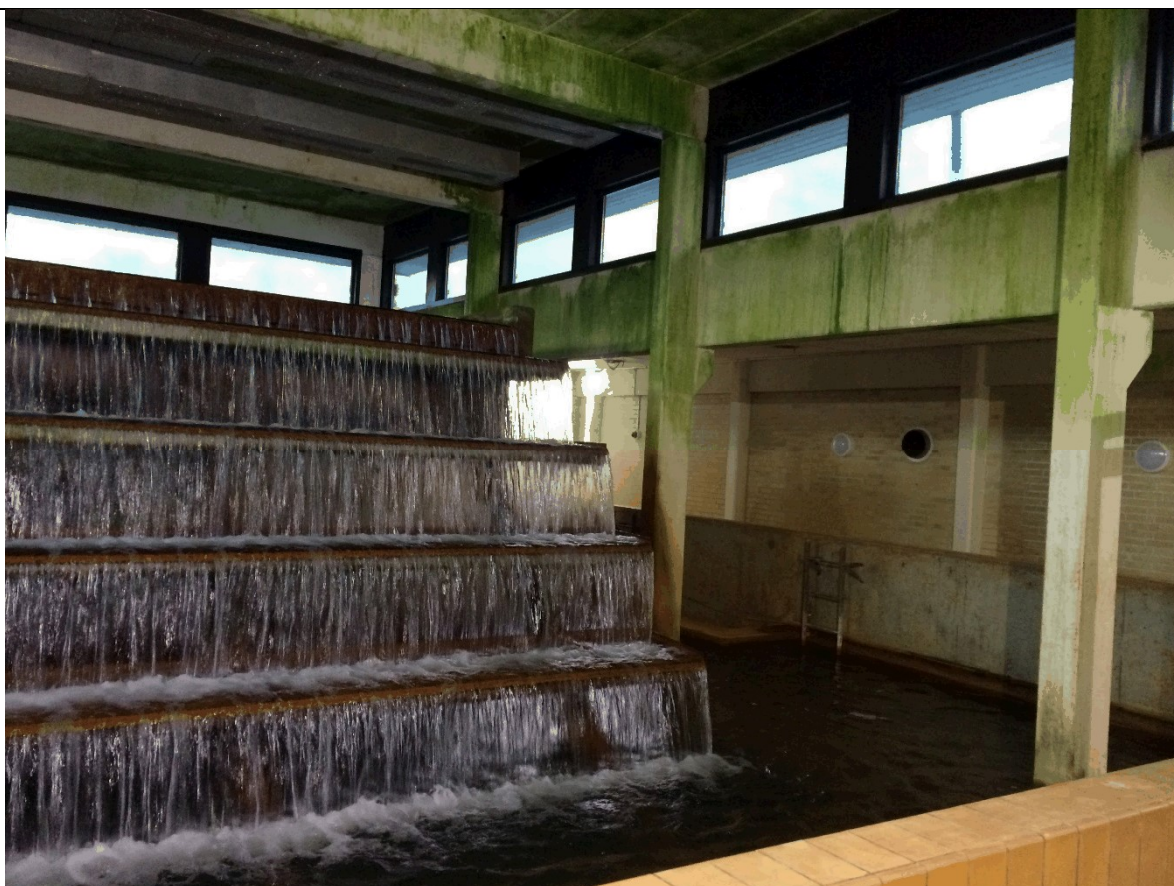
Algevækst i iltningskammer.
