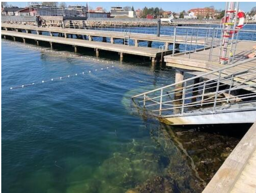
Masser af undersøiske objekter (sten og betonplateau) udgør en fare for de badende. Og derfor anbefales badezonen lukket.
