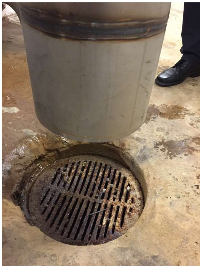
Figur 6. Afstand mellem afløbsrør og rist.
