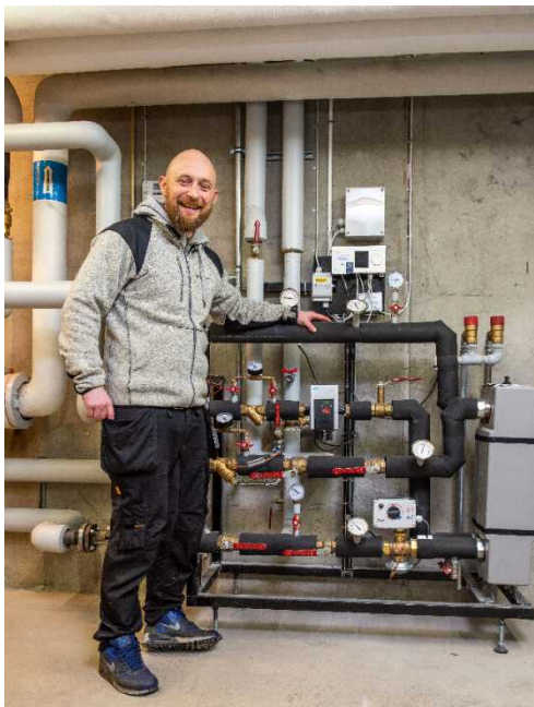
Foto: Bo Hoffmann Østergaard, energikonsulent hos GGF, foran fjernvarmeanlægget på Herthavej 5 A-F, som Gentofte Fjernvarme har overtaget installation, drift og vedligehold af.
