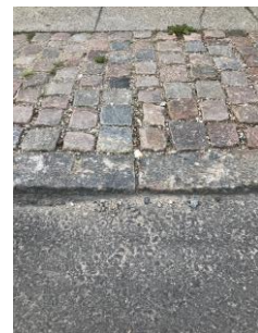
Kantstenen har flere steder lav eller manglende lysning, som derfor øges.
