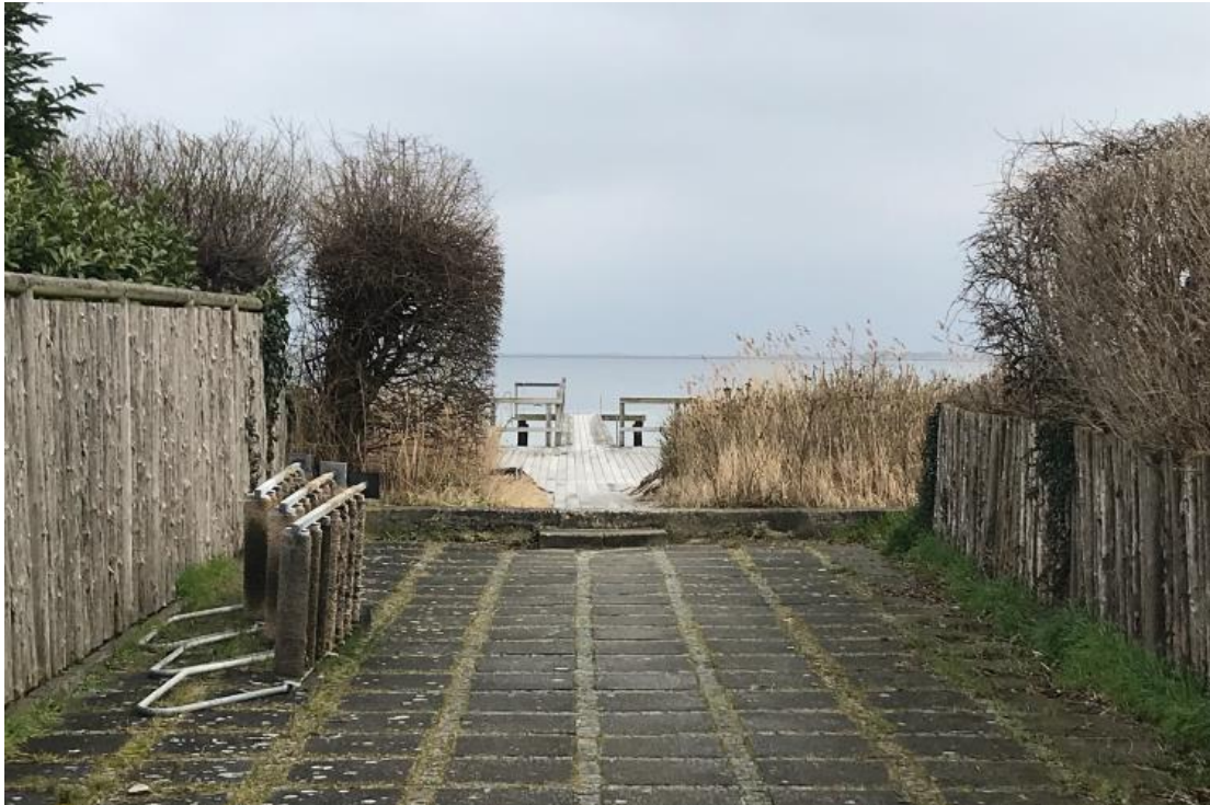
Figur 4 Billede af eksisterende kystsikringsmur ved overgangen mellem Sundvænget (matrikel 33p) og stranden/badebroen
